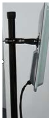
Fixation de l'antenne sur un mât
